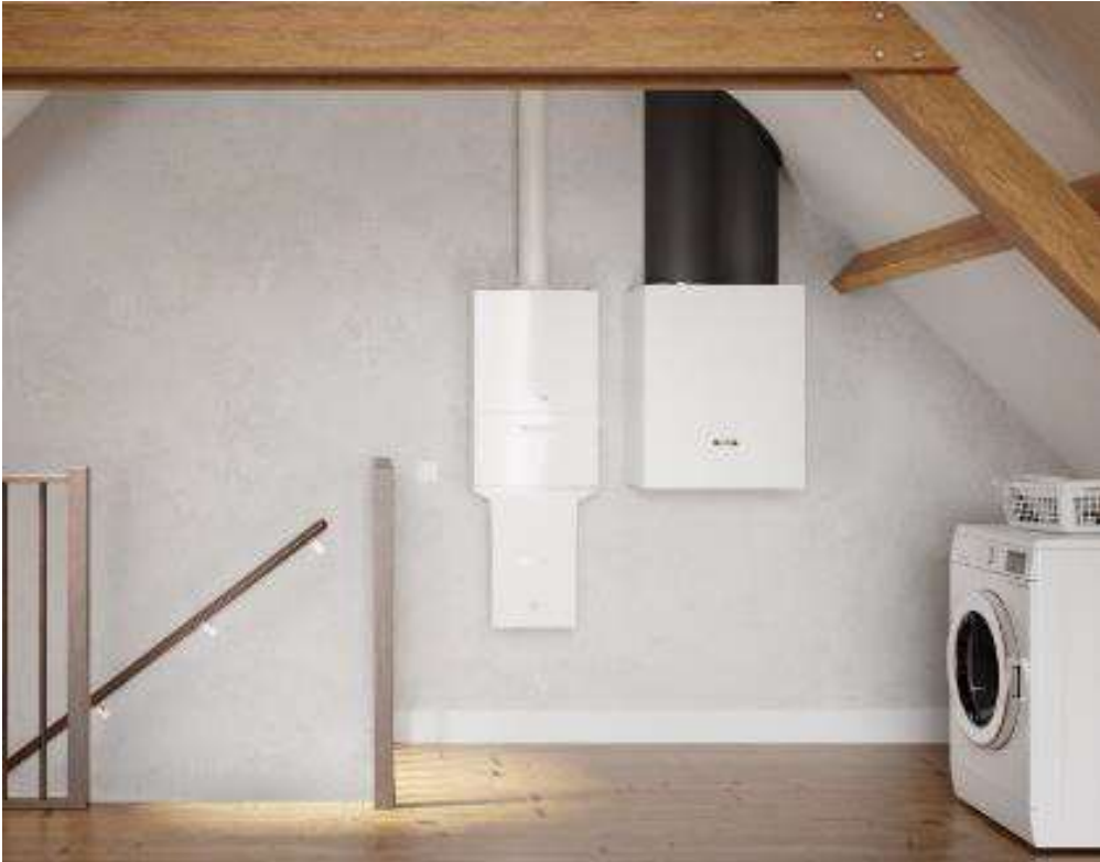
Figuur 1 Atag Interior propaan warmtepomp in combinatie met (bestaande) cv-ketel
