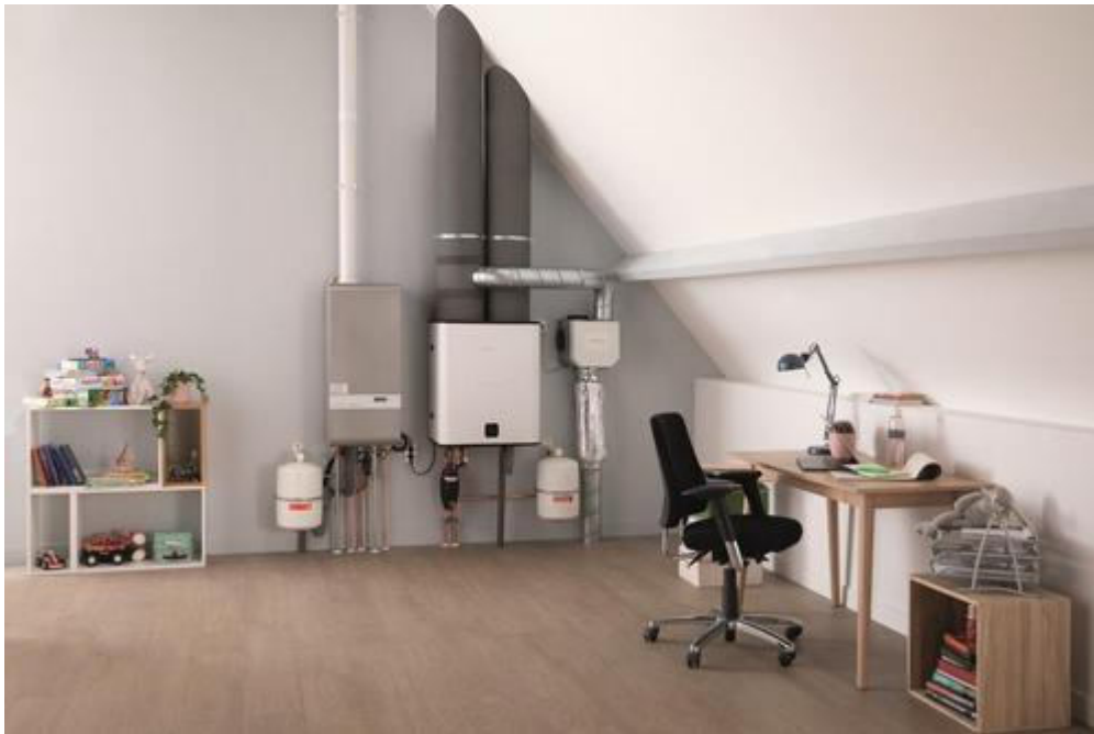
Figuur 1 Itho Vincent hybride warmtepomp in combinatie met (bestaande) cv-ketel
